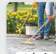
งานซ่อมพื้นอิฐสี Brick floor repair work
